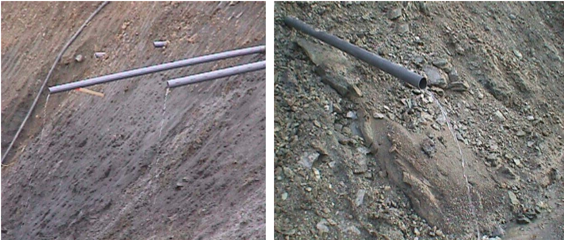
Fig. 6. Eliminación de agua del trasdós de un talud mediante drenes california
