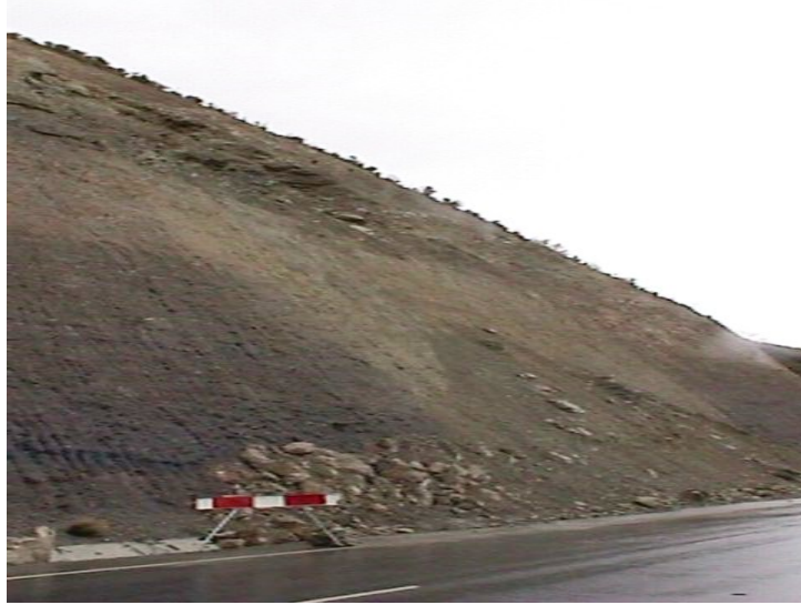
Fig. 7. Deslizamiento plano en talud contiguo a los representados en las figuras anteriores, en el que no se ha hecho uso de drenes
