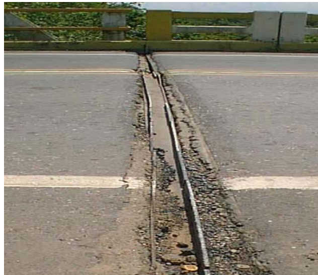
Figura 1. Patologías en los firmes.
