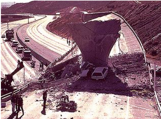
Figura 9. Estructura colapsada por los efectos de un fenómeno sísmico.
