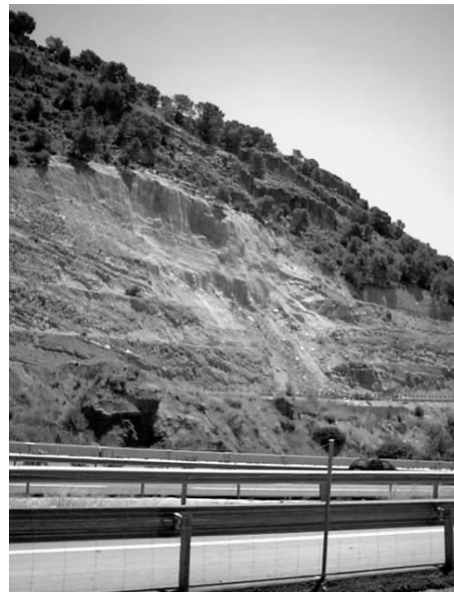
Fig.1.- Vista de la situación actual del desmonte situado en la carretera A-324 correspondiente a la intersección de la CN-323 dirección Cambil.
